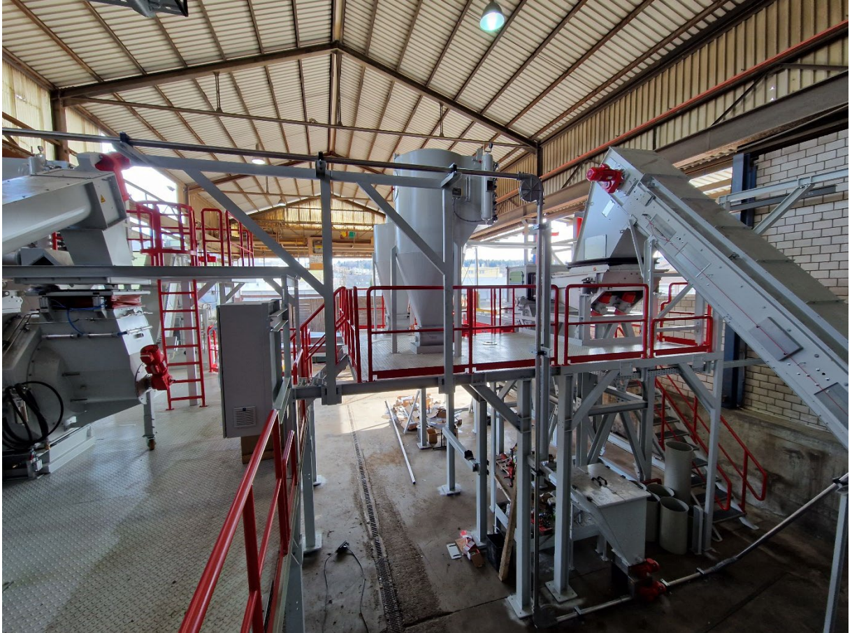
URT-Kühlgeräte-Recyclinganlage im Aufbau. Links: Pelletierpresse, rechts: Kunststoff-/ Aluminium-Austragband auf Wirbelstromanlage
