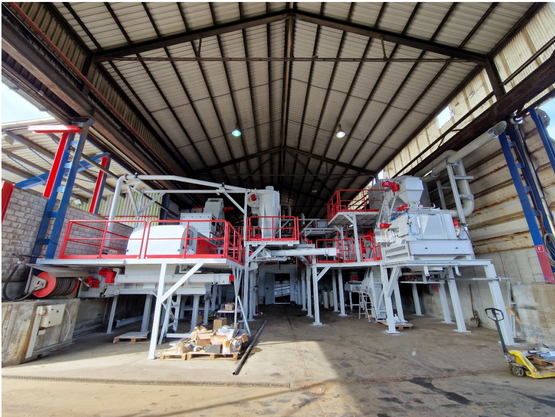
URT-Kühlgeräte-Recyclinganlage im Aufbau. Links: Wirbelstromabscheider, rechts: Pelletkühler
